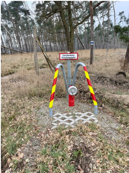
Bild 1: Löschwasserentnahmestelle – entscheidend für schnelle Einsatzfähigkeit im Ernstfall.
