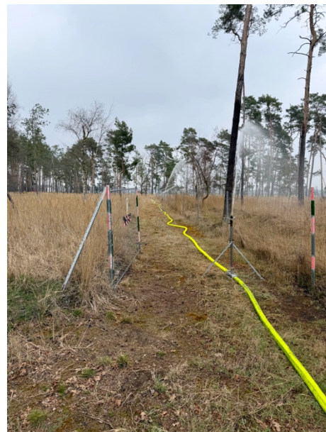
Abbildung 4: Einsatzbereit vor Ort: Kreisberegnungsanlage zur effektiven Waldbrandbekämpfung im Praxiseinsatz.
